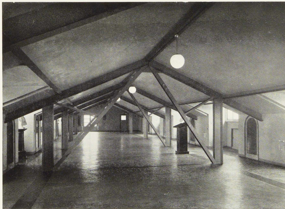
Fig. 516. Vue des combles. L'ossature métallique laissée à nu a été soulignée par des peintures aux couleurs vives.
