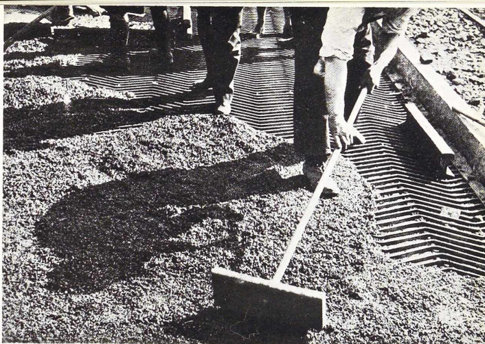
Fig. 208. Le grillage est recouvert d'une couche de 3 cm. d'émulsion de bitume qui pénétrera entre les barreaux des grilles après cylindrage.
