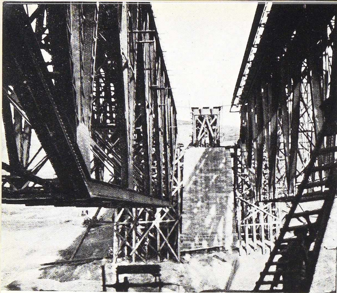
Fig. 133. Vue de la travée nouvelle de 100 m. (à gauche) au moment où elle va être ripée sur les piles d'appui. L'ancienne travée vient d'être déplacée dégageant l'appui vu au centre de la figure.
