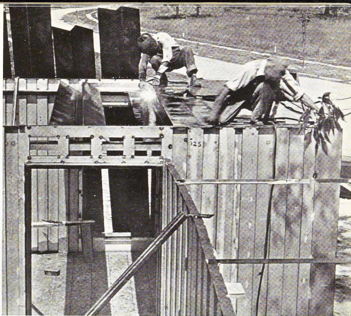
Fig. 64. Montage du plancher de l'étage. Soudure des éléments en forme de Z. Vue du plat de renfort fixé à la partie supérieure des tôles des murs.
