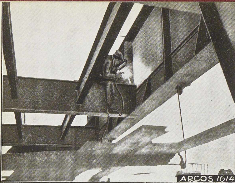
Fig. 42. Second pont-route soudé de Lowicz. Détail des entretoises et des longrines. Soudage d'un gousset trapézoïdal à un raidisseur. * Arcos, n° 47, janv. 1932.
